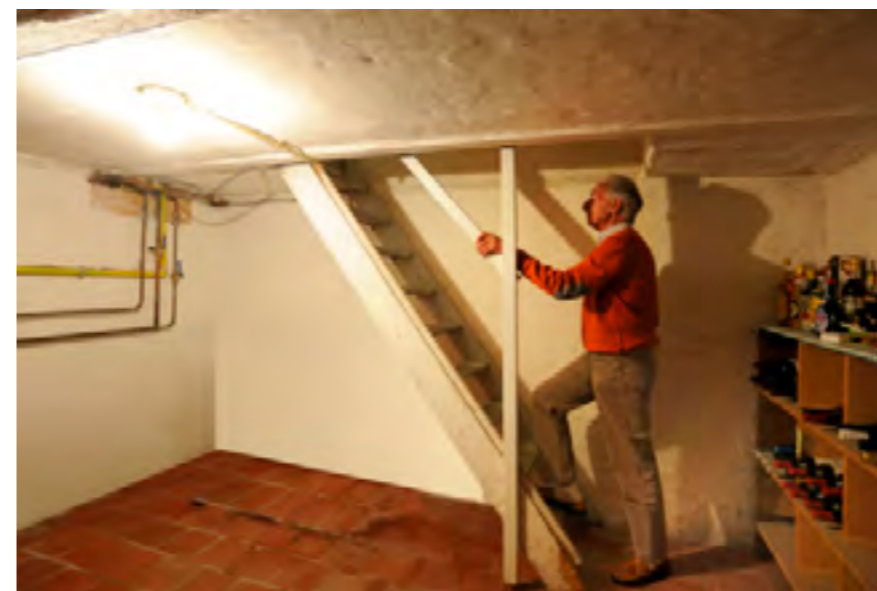
Jochem Gommans op de keldertrap, anno 2014, rechts onder hem was hun kelder doorgebroken naar die van de burens. (foto Jacques Peeters)
